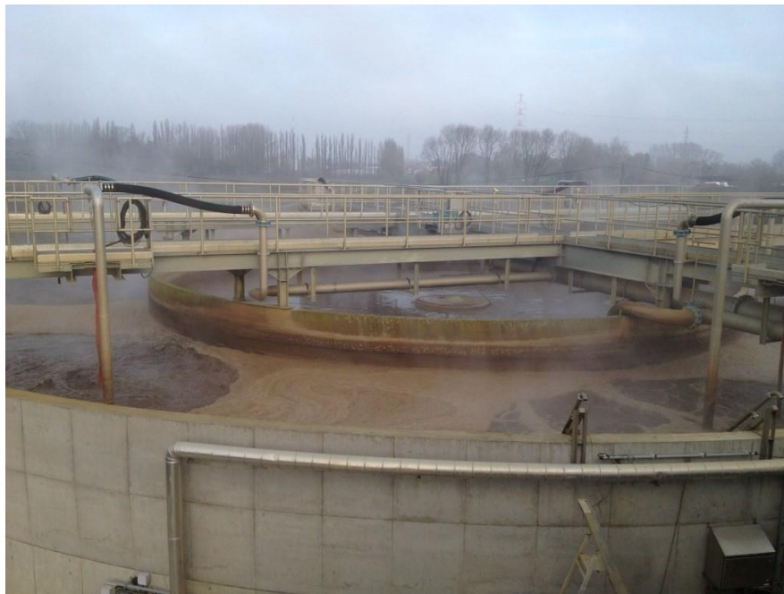
Figuur 24 Overzicht aerobisch zuiveringsgedeelte
